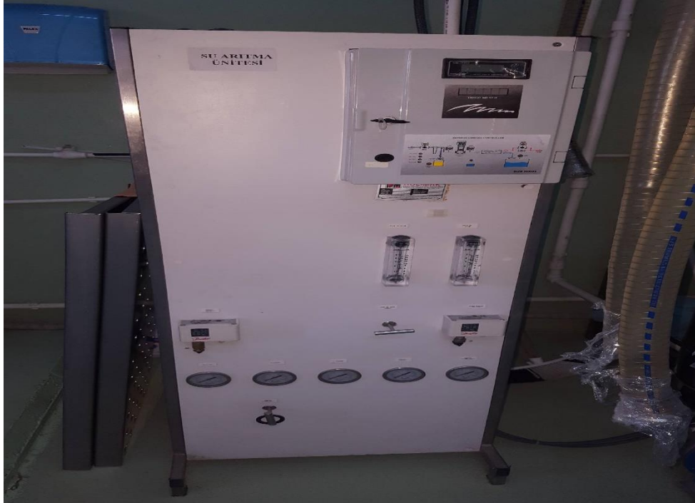
Şekil: 5.2. Su Arıtma Ünitesi
