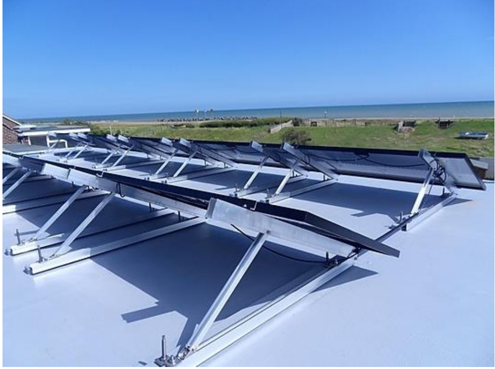
Kaynak: http://www.ecohisolar.co.uk/case-studies/sanyo-on-flat-roof Şekil 4.12 Düz Çatıda Ek Strüktür İle Fotovoltaik Panel Uygulaması
